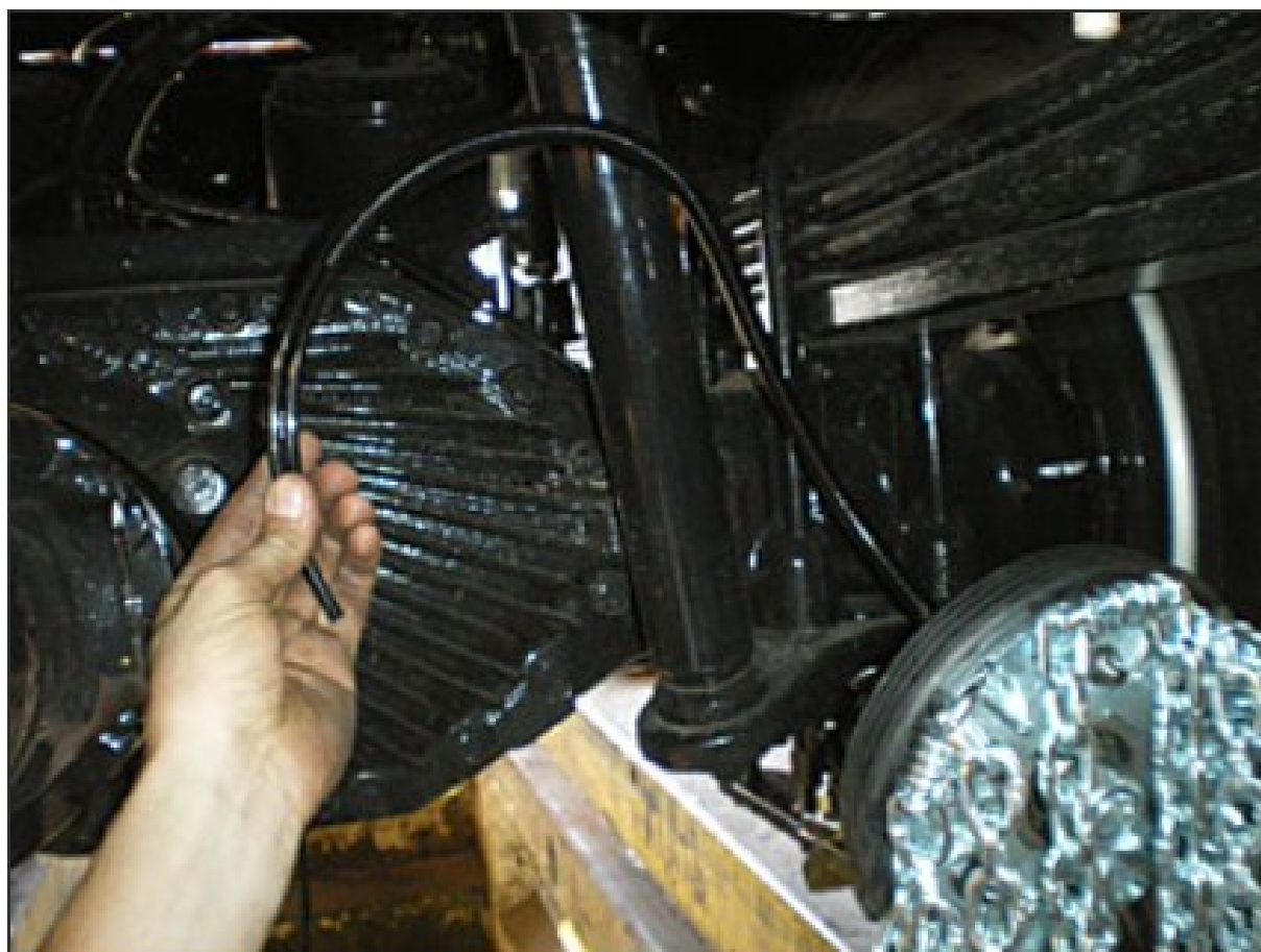
Vzduchová vedení jsou vedena od pohonných jednotek k regulačnímu ventilu
